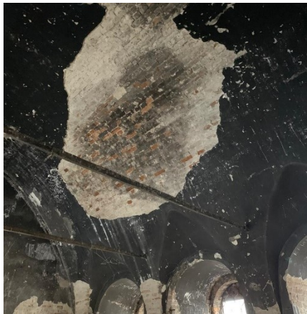
Рисунок 5 – Состояние свода храма
