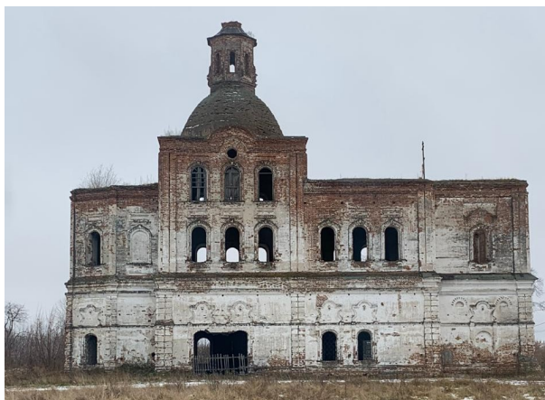
Рисунок 2 – Вид здания церкви на момент обследования
