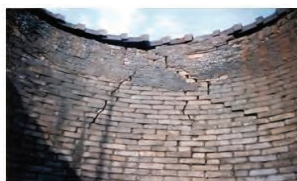
Трещины в верхней части футеровки
