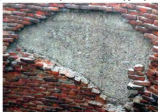
Разрушение внутреннего защитного слоя
