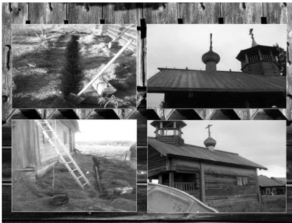
Ил. 4. Устройство молниезащиты на объекте «Часовня Введения Богородицы во Храм 1801 г.» д. Рыжково.
