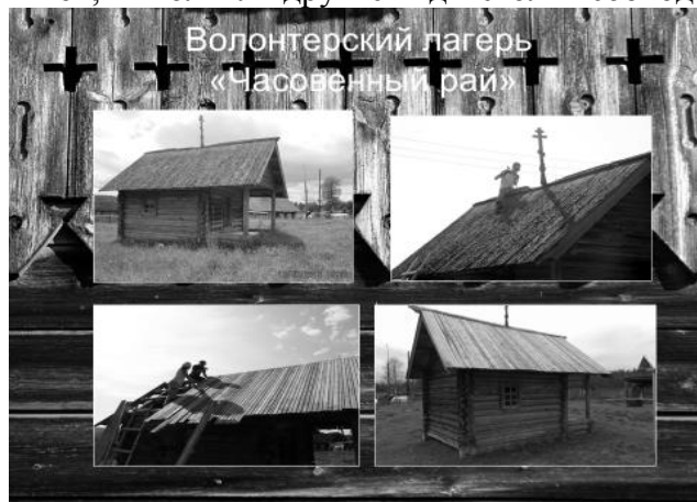
Ил. 5. Фото объекта после консервационных работ «Часовня Анастасии Узорешительницы 1920 г.» д. Косицыно
