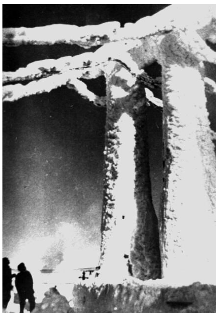
Рис.1. Состояние линии электропередачи после снежной бури в Павлодарской области
