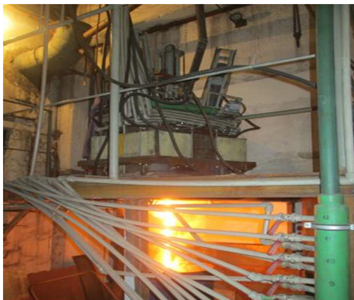
Рисунок 1 – Общий вид пилотной установки с электромагнитным реактором, установленного на эстакаде
