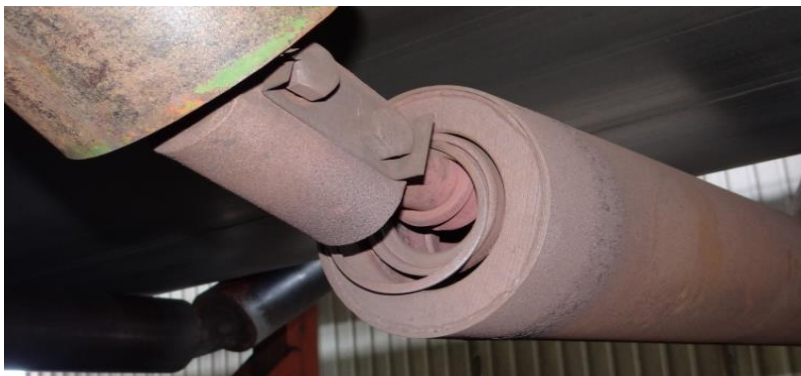
Рисунок 2. Выход из строя отдельных роликов, вследствие разрушения подшипников
